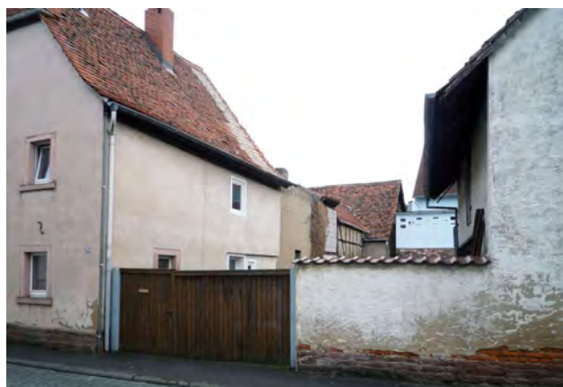
Gehöft in der Hauptstraße in schlechtem baulichem Zustand
