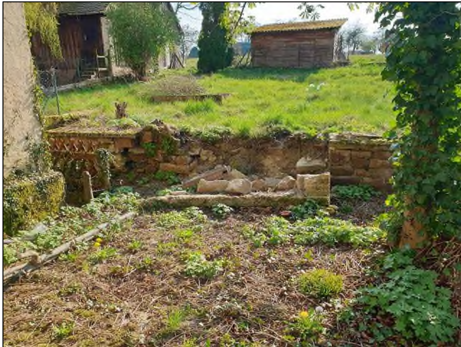
Abb. 6 Zerfallende Trockenmauer, im Garten hinter dem bestehenden Gebäude (09.04.2020)
